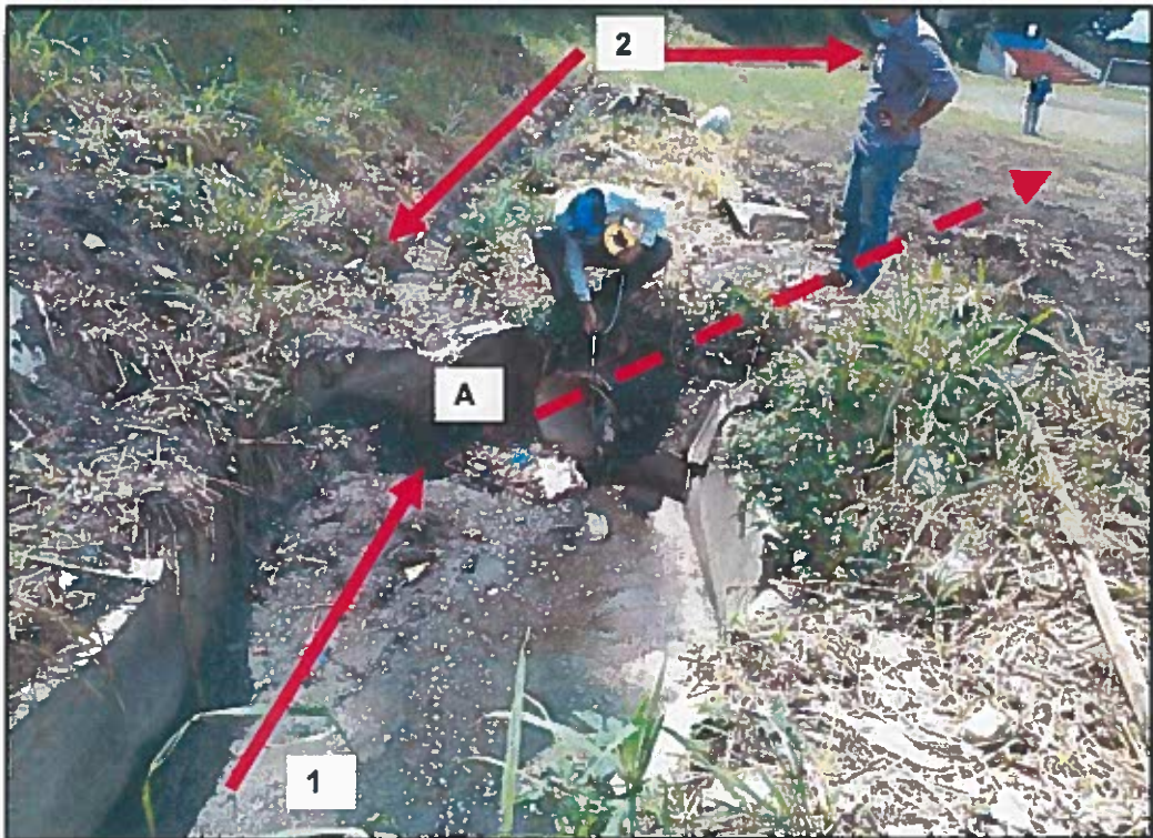
TUBO TRANSVERSAL EXISTE DE 0.90 m, POR DEBAJO DEL CAMPO DE FUTBOL
