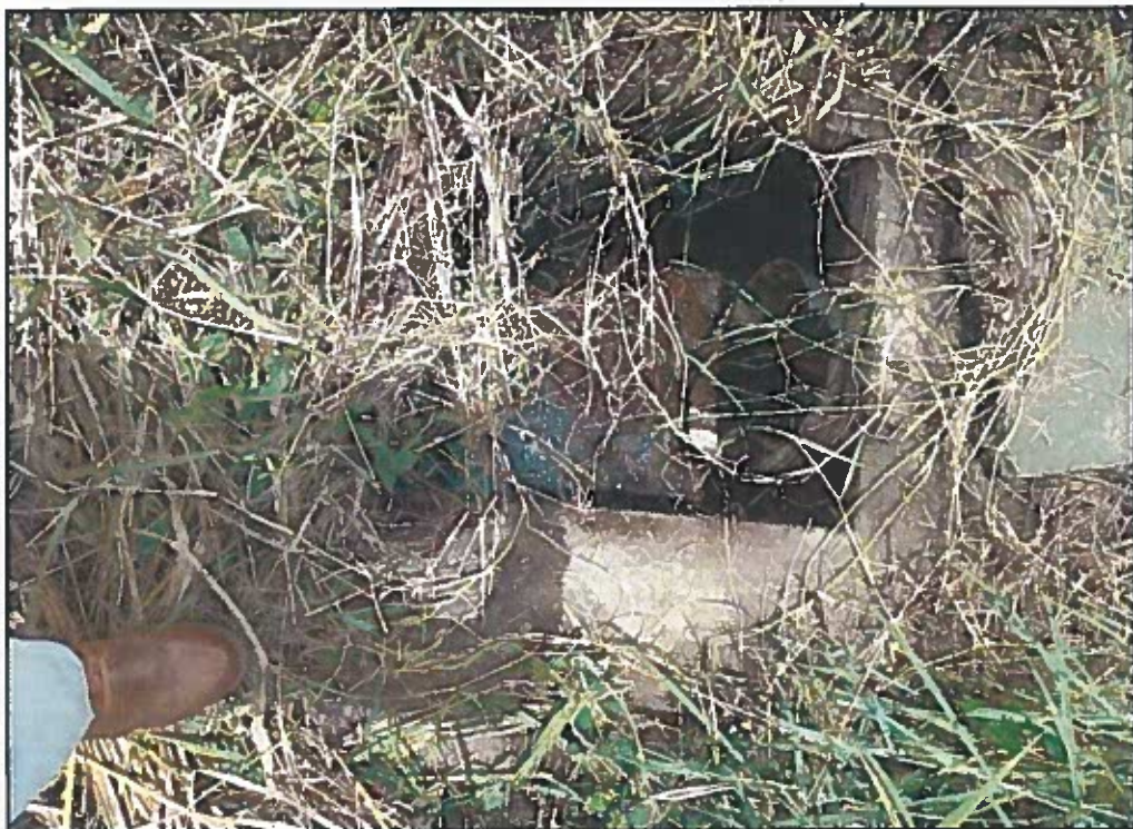
PUNTO 5, C.I EXISTE TUBO DE 0.90 m hacia calle
