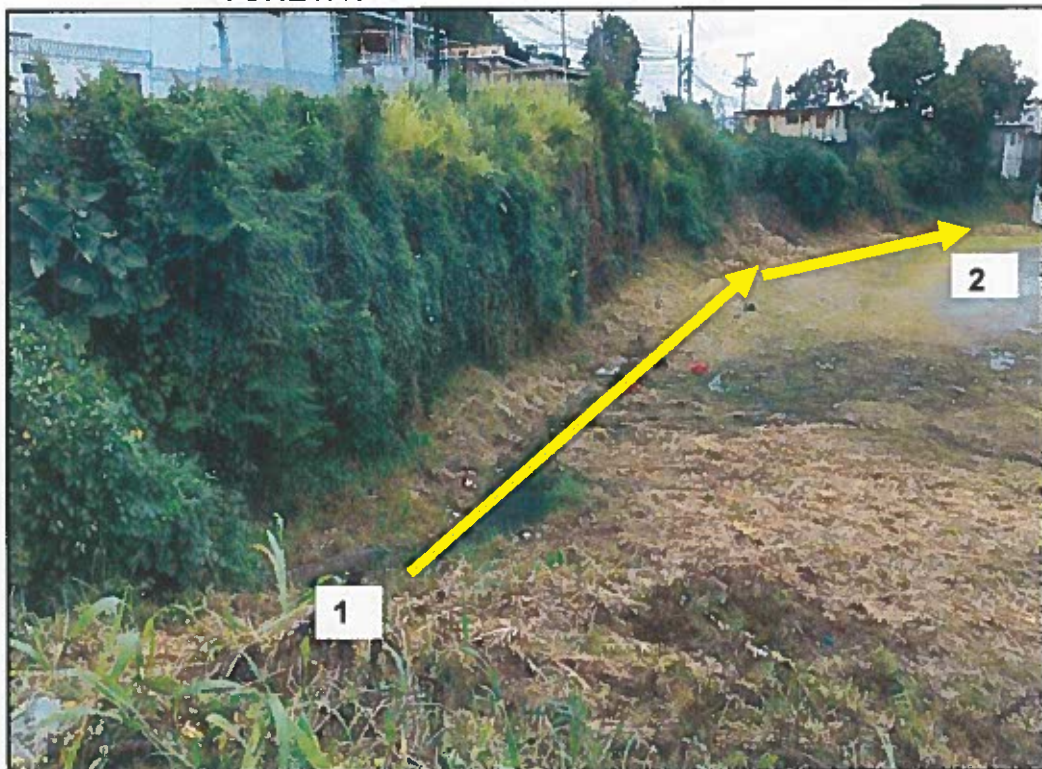
CUNETA PAVIMENTADA SEDIMENTADA A REEMPLAZAR
