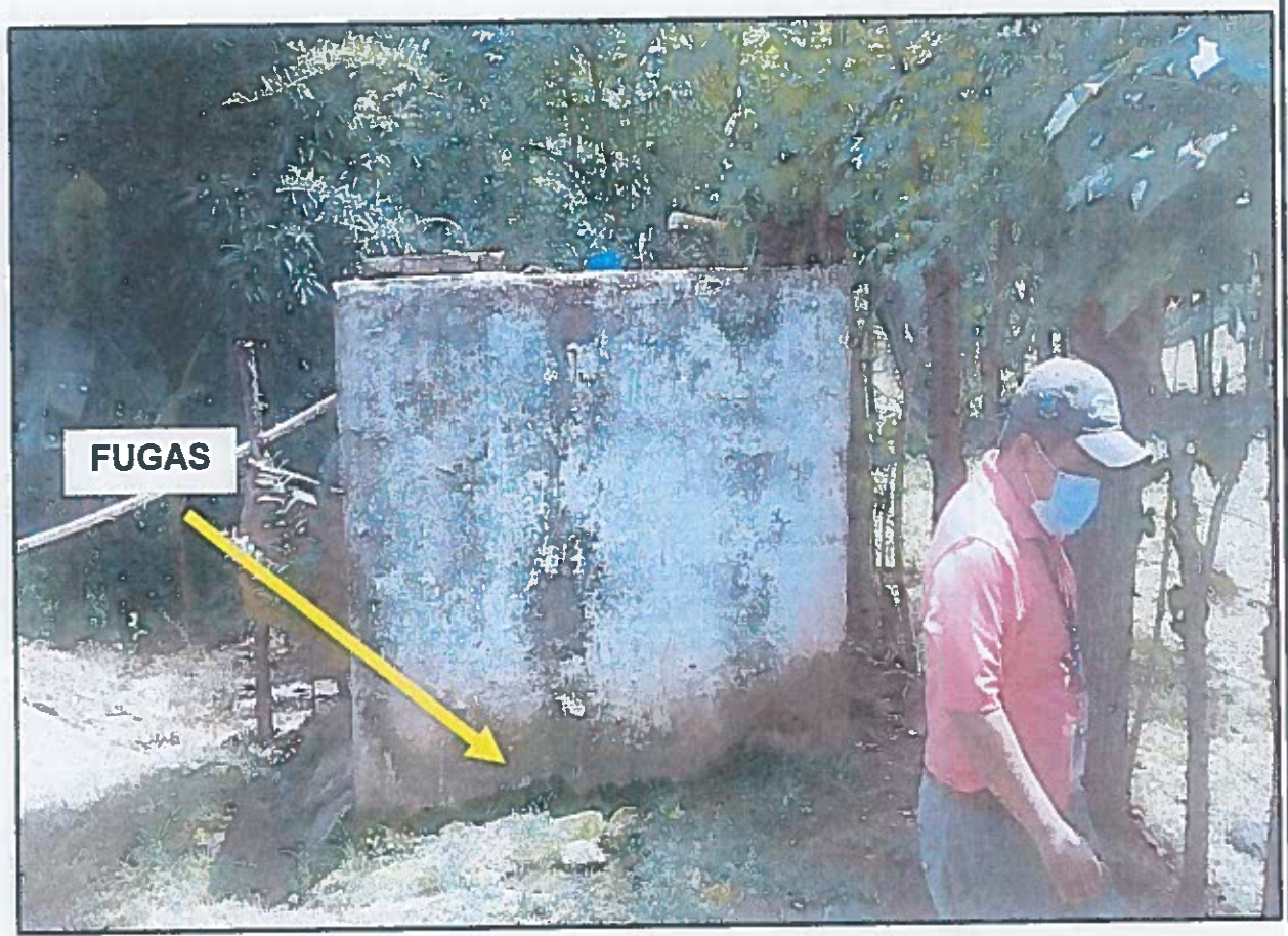
TANQUE EXISTENTE EN MALAS CONDICIONES
