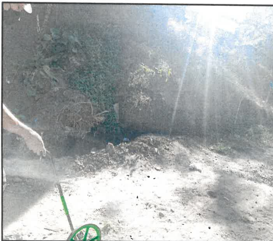
ok + 037.50(derrumbe lat. Izquierdo)
